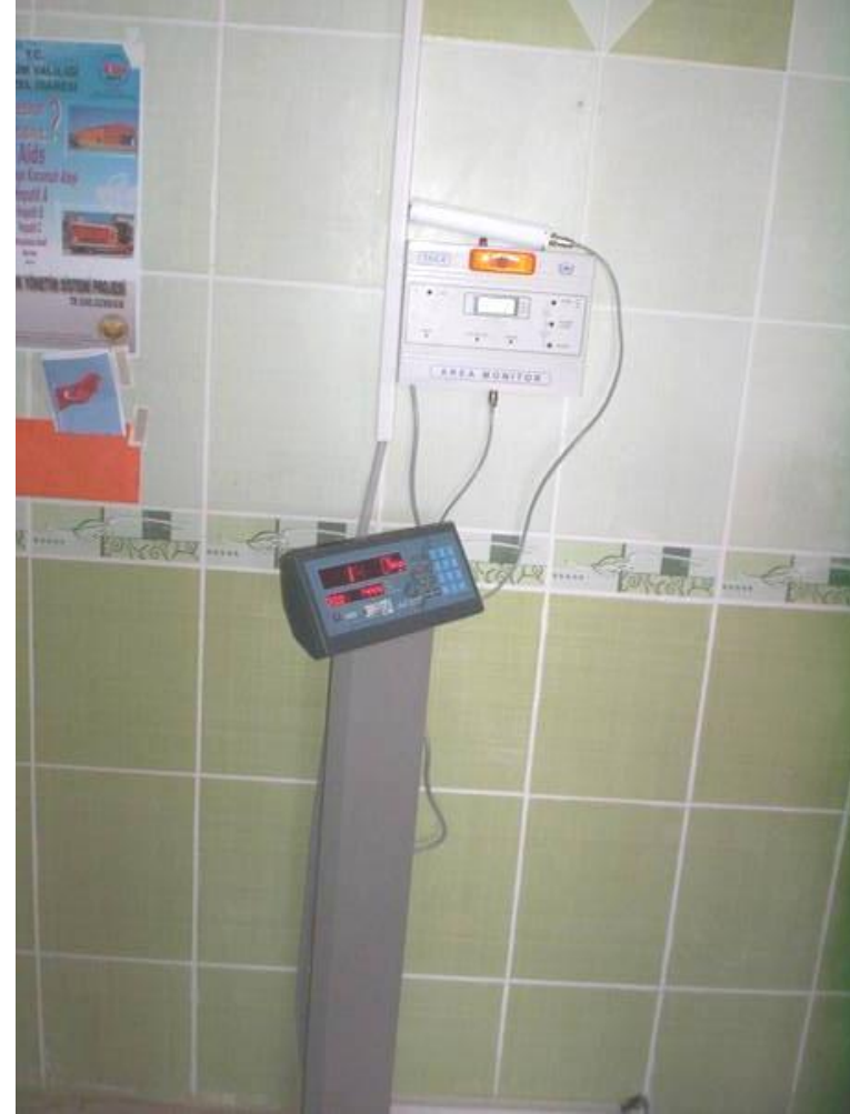
Tıbbi atık elektronik kontrol alarm panelleri
