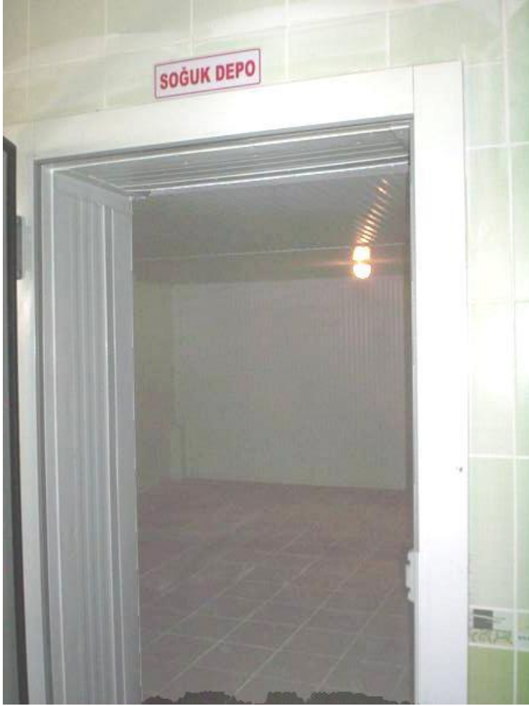
Tıbbi atık saklama soğuk hava deposu
